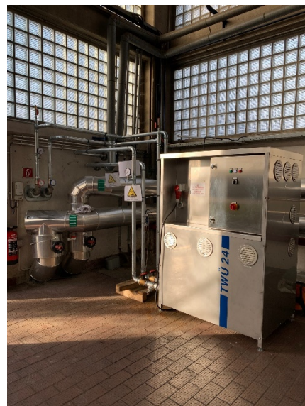
Abbildung 1: Wärmeübergabestation MHKW, Bremen
