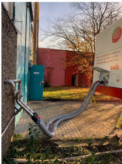
Abbildung 2: Mobiler Speicher während der thermischen Beladung am MHKW, Bremen.
